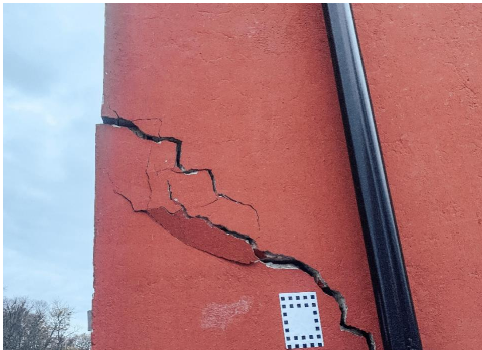
Figur 4: Riss i betongvegg på Studentersamfundet. Foto: Julie Waaler
