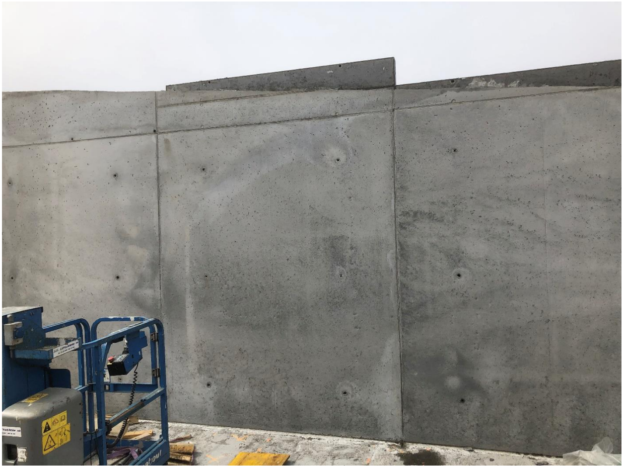
Figur 28. Basaltvegg før overflatebehandling. Foto: Kjell Nordli
