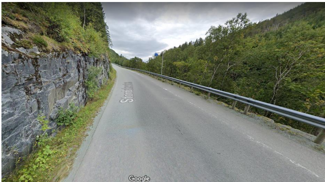
Bilde 7. Bildet illustrerer mangelen av tilstrekkelige grøfter i bergskjæringer (Google, 2019).
