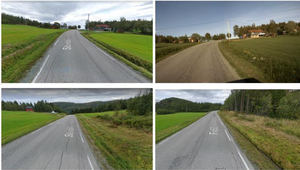
Bilde 17. Figuren viser bilder tatt fra forskjellige steder langs strekningen med dekkeskader. Langsgående sprekker, krakelering og ujevnheter kan observeres (Statens vegvesen, 2021a & Statens vegvesen, 2022b).
