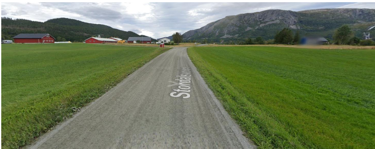
Bilde 9. Bildet viser manglende grøftedybde, By (Google, 2019).
