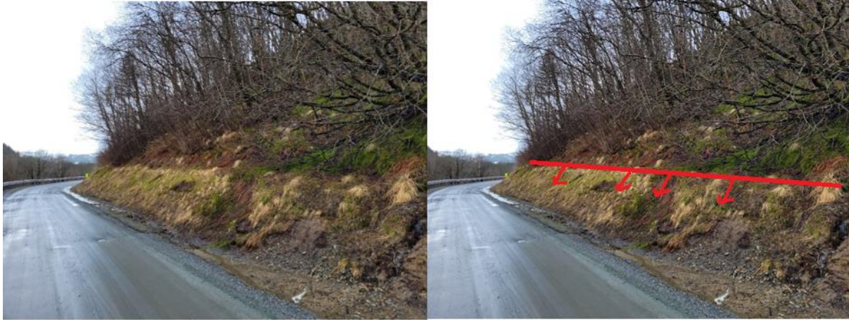
Figur 27. Figuren viser hvordan løsmassene på oversiden av veggen ved Årbogen glir nedover skråningen. Bildet er tatt på befaring i Åffjord (Privat, 2022).
