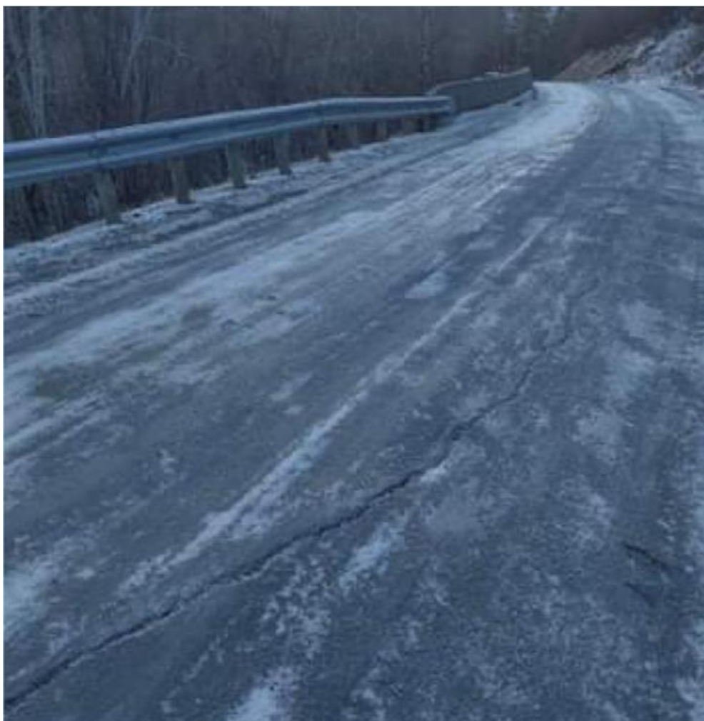
Bilde 18. Observert sprekk på fv. 6328 sett østfra, med enden av betongrekkverk på km 4,905 (Årbogen, 2021).
