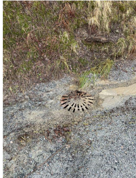
Bilde 11. Bilde av overfylt sandfangskum fra befaring ved Årbofossen (Privat, 2022).
