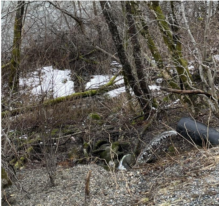
Bilde 13. Bildet viser gjennomløp som slipper vann ut i skråningen uten noe særlig tiltak som forhindrer erosjon. Bildet er tatt på befarings i Åfjord (Privat, 2022).
