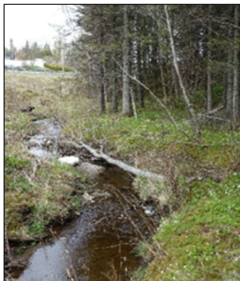
Figur 32 – Eksisterende bekkeløp med behov for utbedring
