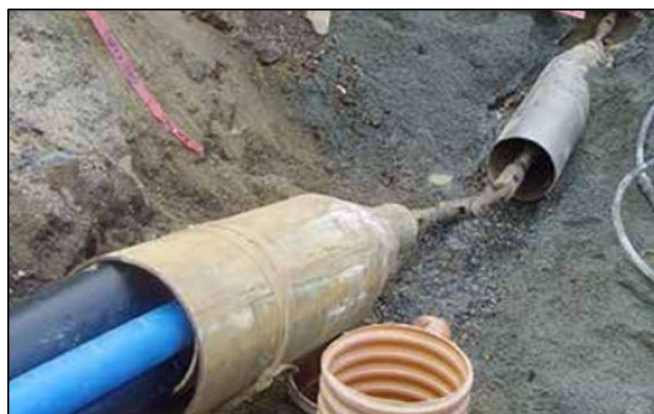
Figur 25 – Utblokking med inntrekning av flere mindre rør, figur hentet fra (Olimb AS, 2018)
