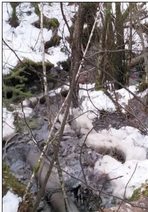
Figur 39 - Bilde fra traséen ned Kl.10 Berget, ledningen ligger stedvis i dagen og går med krappe bend, Bilde hentet fra driftsrapport i Gemini.
