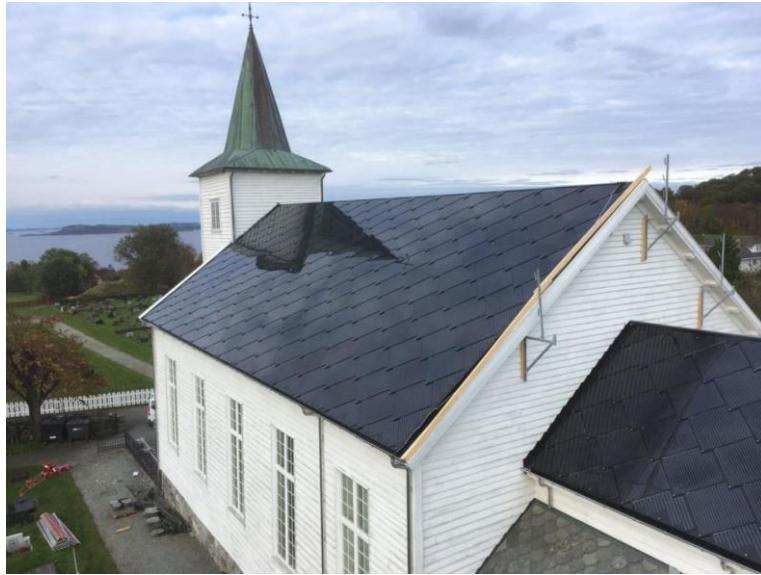
Figur 22 Bygnings-integrerte solcellepaneler på Strand kirke.
