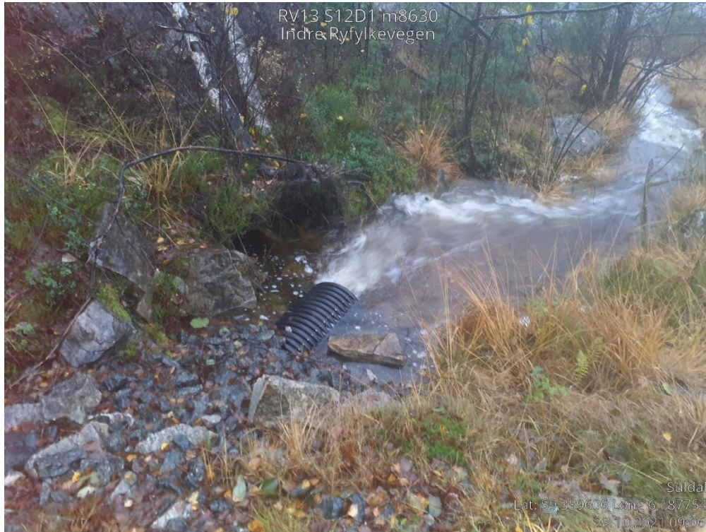
Figur 16: Bilde av stikkrenne under stor nedbør på Rv13 (denne er byttet ut i etterkant med en av større dimensjon).
