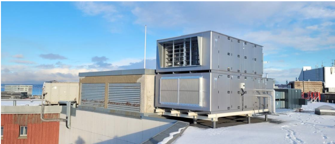
Figur 52 Gammelt tekniskrom med ventilasjonsinntak (venstre) og nytt ventilasjonsanlegg (høyre). Foto: Simon Johansen
