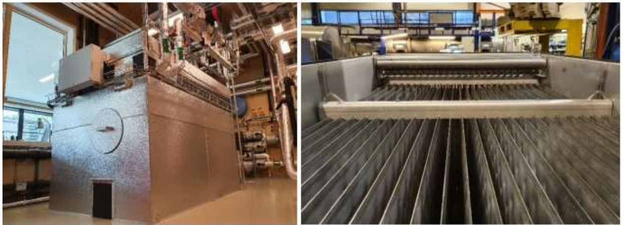
Figur 38: 200kWh PCM-varmelager installert i ZEB-laboratoriet (venstre); Pute-plater inn i varmelageret, uten PCM (høyre). Hentet fra: [72]
