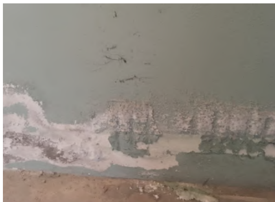
Fig. 17: Saltutslag som følge av fuktskade i murgård [47]
