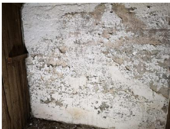
Fig. 18: Malingsflass som følge av fuktskade på murgård [22]
