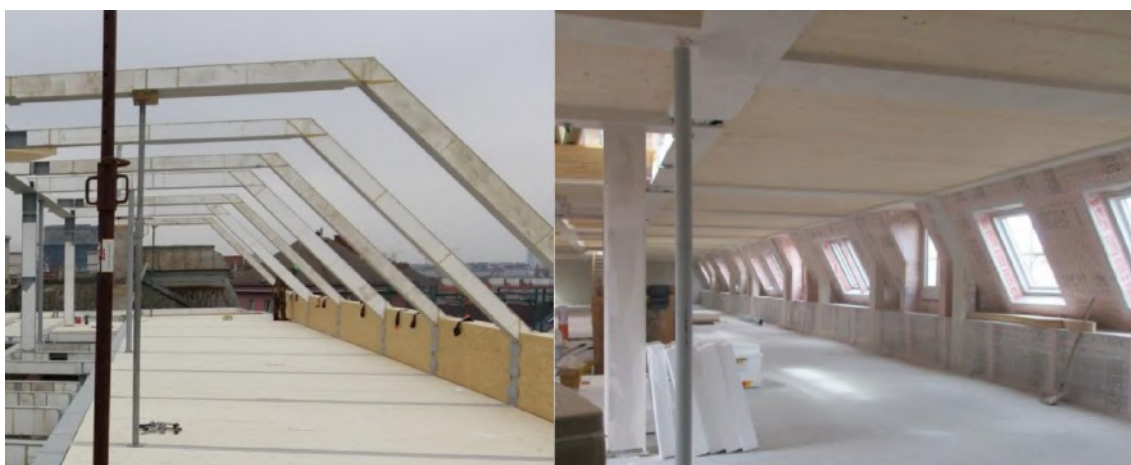
Fig. 73: Detaljer fra et utbyggingsprosjekt i Østerrike med ståldragere og elementer. Hentet fra [18].
