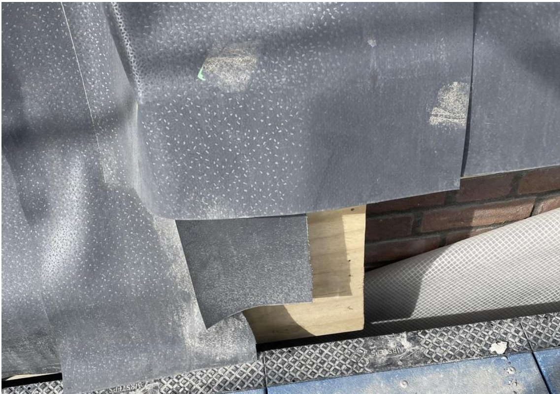
Fig. 71: Gesims overgang ved trapping av byggene
