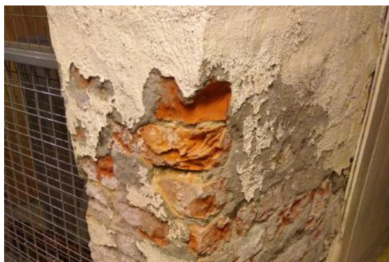
Fig. 19: Saltsprenging som følge av krystallisering i materialet [23]
