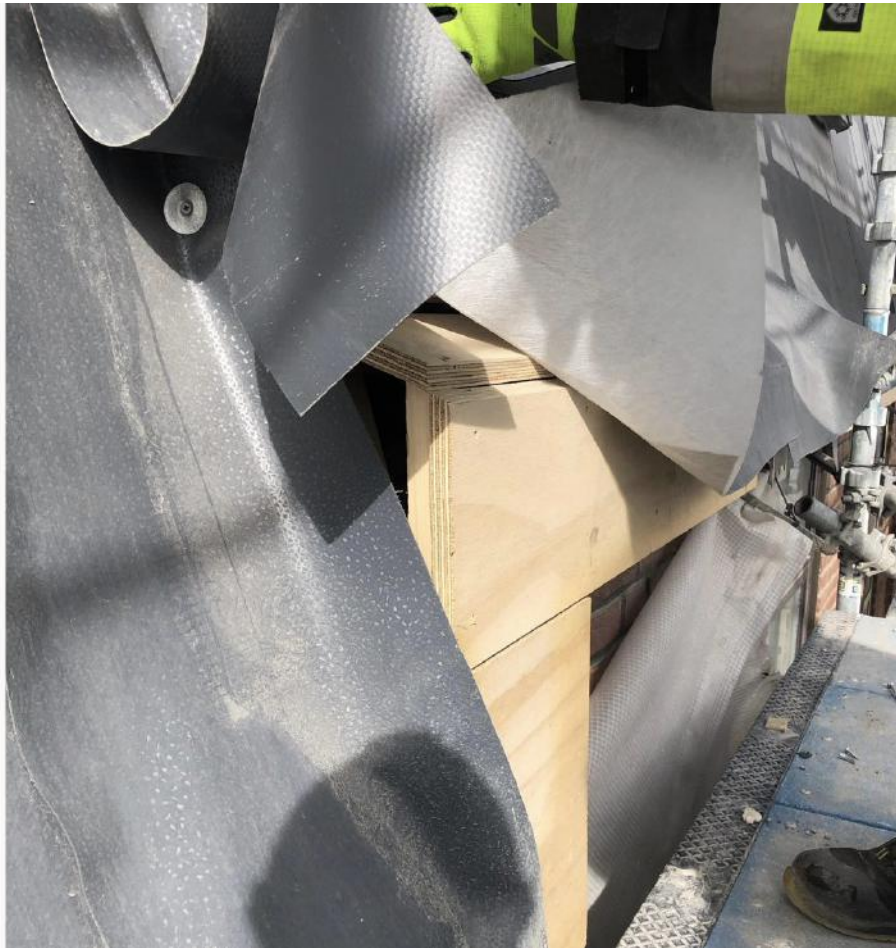
Fig. 72: Gesims overgang ved trapping av byggene
