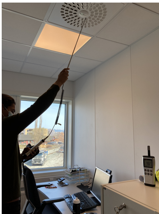
Figur 17 - Temperaturmåling ved integrert sensor i tilluftsventil
