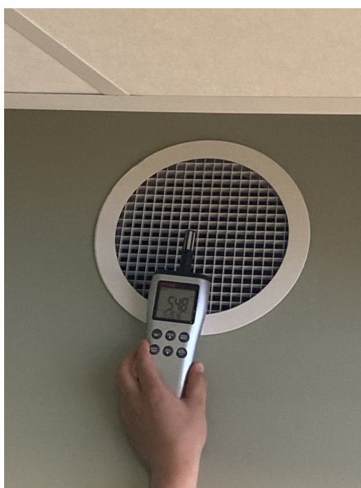
Figur 15 – CO 2 -måling ved avtrekksventil
