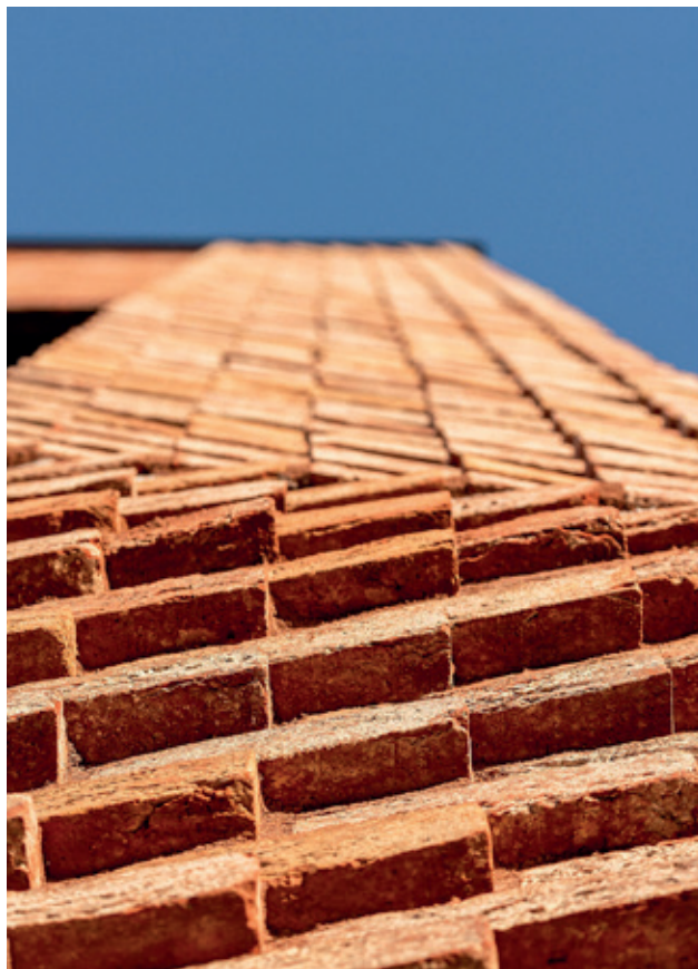
Sett nedenfra. Skråstilt tegl på pilastre gir mye å feste blikket ved.
