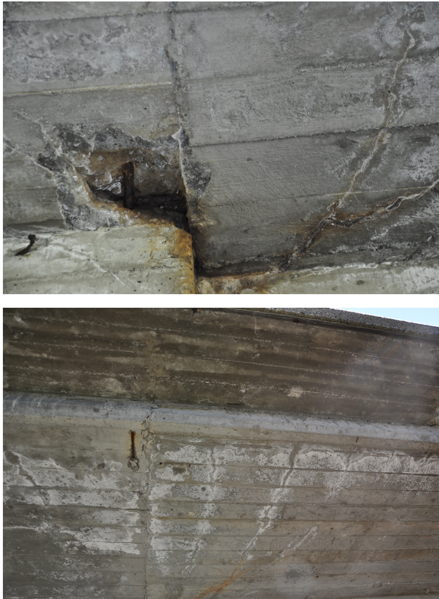
Figur 6.6: Avskalling og synleg armering (Statens Vegvesen, 2021).
