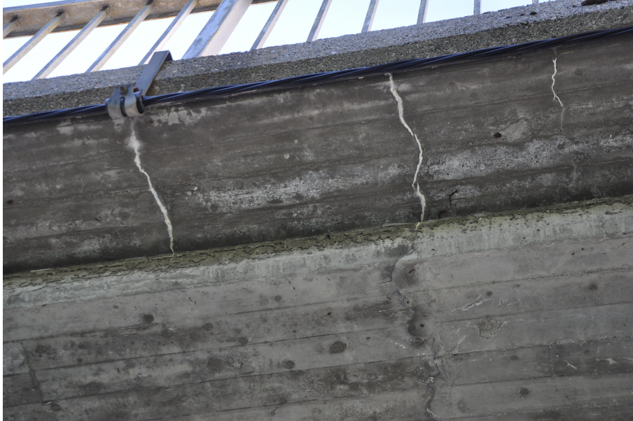
Figur 6.4: Riss på bruvengje med utfellingsprodukt (Statens Vegvesen, 2021).
