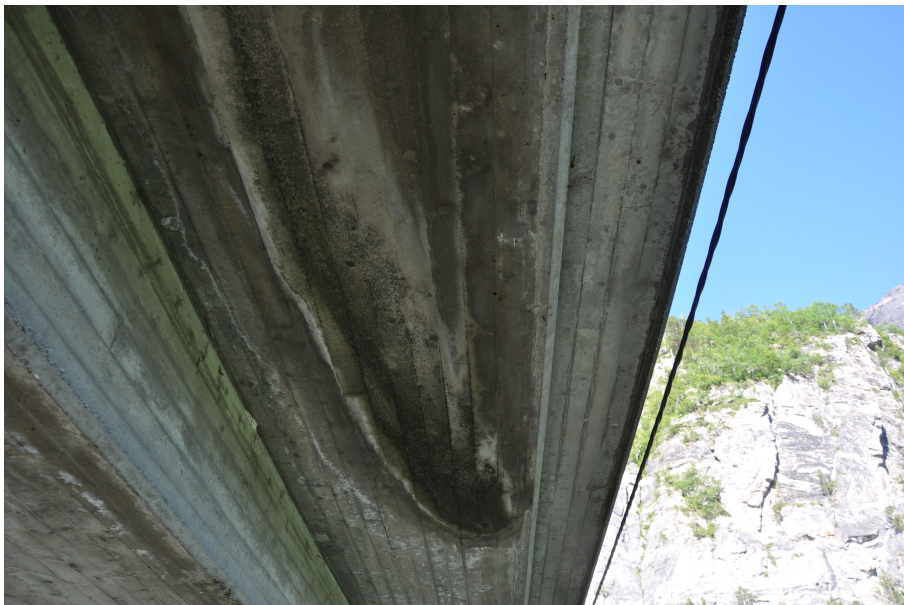
Figur 6.5: Fuktgjennomslag i underkant av brubana (Statens Vegvesen, 2021).
