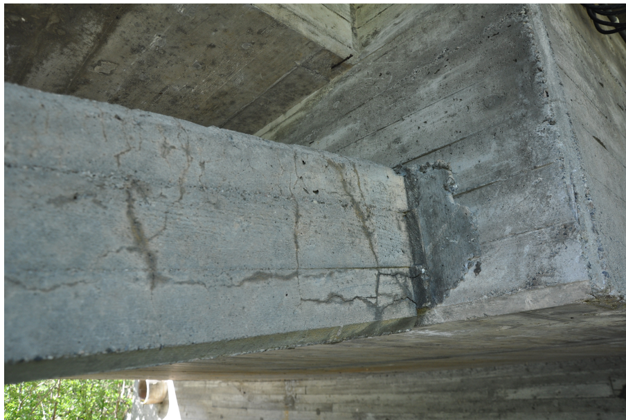
Figur 6.10: Riss på strekkband (Statens Vegvesen, 2021).
