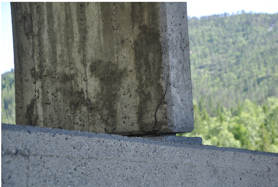
Figur 6.8: Riss i underkant av vegg søyle nr. 6 (Statens Vegvesen, 2021).
