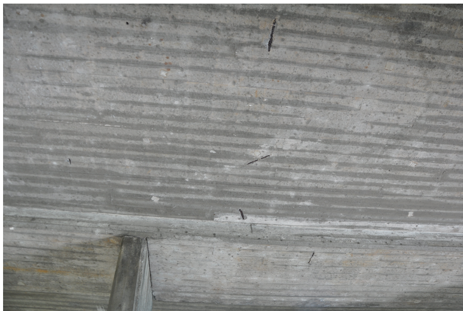
Figur 6.7: Lite overdekning og synleg armering (Statens Vegvesen, 2021).
