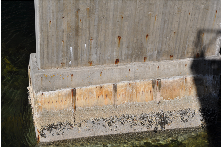
Figur 6.13: Korrosjonsprodukt frå armeringsstag (Statens Vegvesen, 2021).
