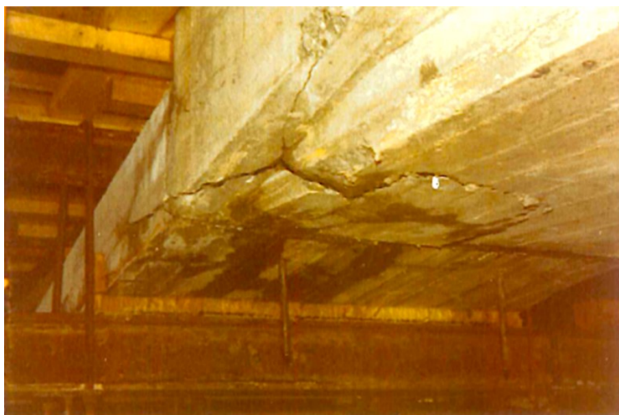
Figur 5.18: Sprekker i overgang mellom strekkband og viadukt etter andre oppspennings-trinn (Vik, 1970a).
