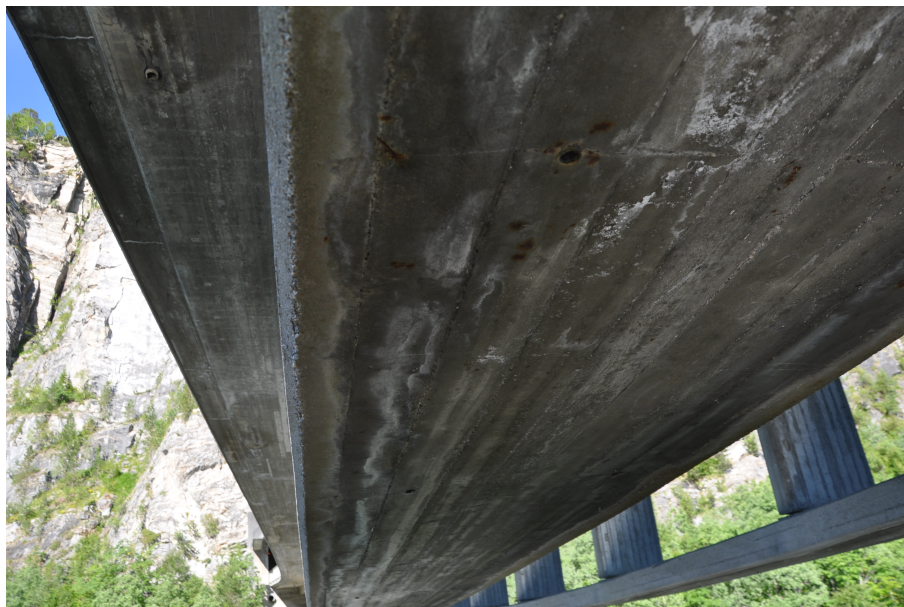
Figur 6.12: Kalkutfelling på underside av strekkband (Statens Vegvesen, 2021).
