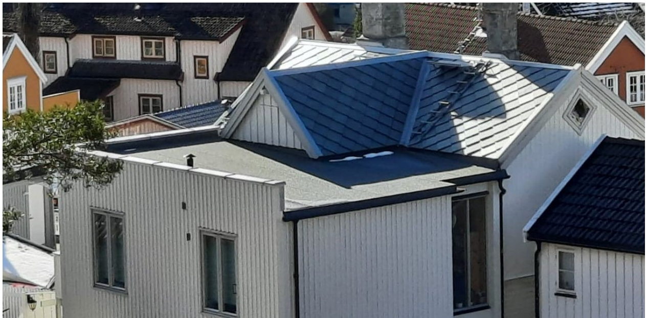
Figur 2: Kompakt tak med utvendig nedløp i Trondheim, en løsning som ofte blir brukt der parapet fjernes fra den ene siden til fordel for nedløpene. Uttørring av vegg hvor parapet fjernes vil bli en utfordring. Foto: Vegard A. Skagseth
