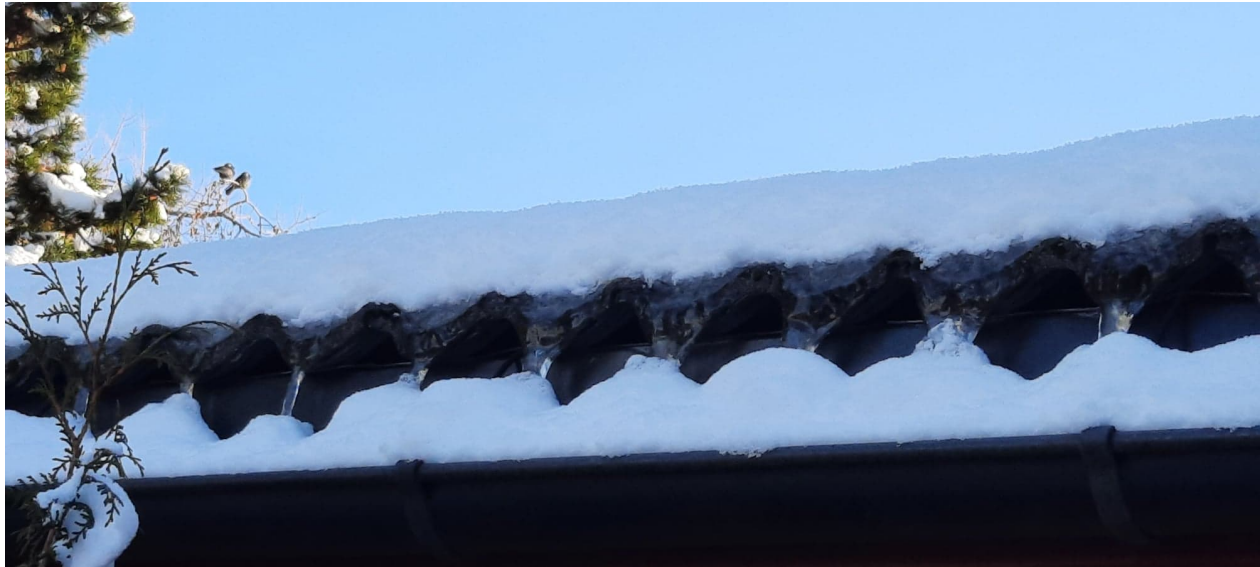
(a) Tak som er dårlig isolert og/eller utilstrekkelig luftet som fører til isdammer på utstikk og istapper nedenfor. Merk at snødybden på taket er lav. Foto: Vegard A. Skagseth. Tidspunkt: 3. februar 2021 kl 12:19. Posisjon: Nardo, Trondheim
