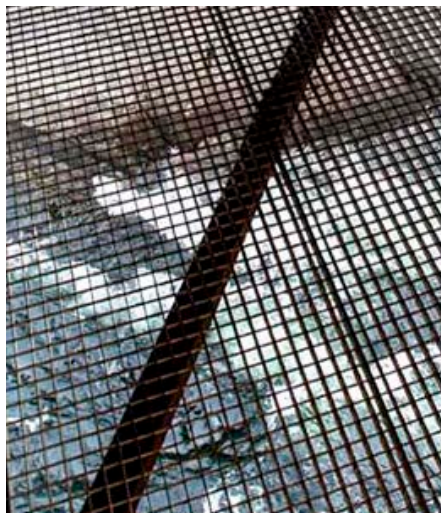
Metallrister i gulv i uterom og som inngangsrister
