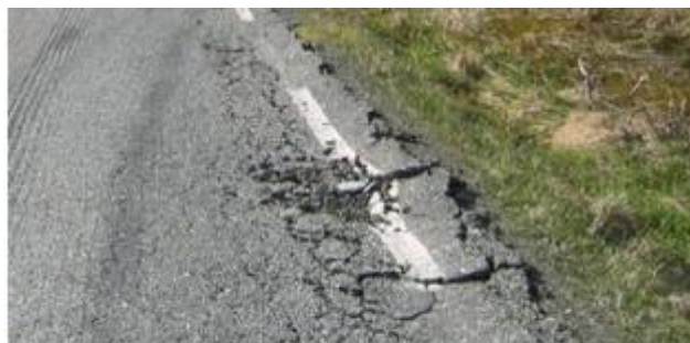
Figur 34 - Deformert skulder som følge av smal veg (Foto: Roadex.org)
