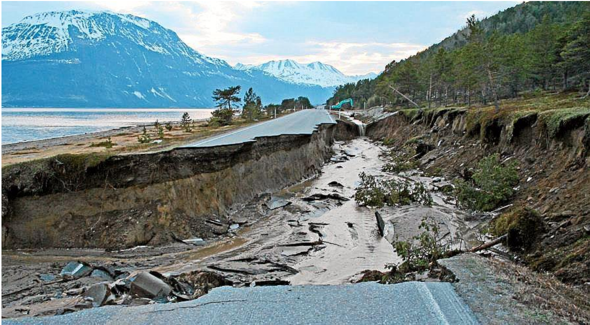
Figur 4 - Flomhendelse på E6 i Kåfjord. Foto: Svein Eriksen/Scanpix
