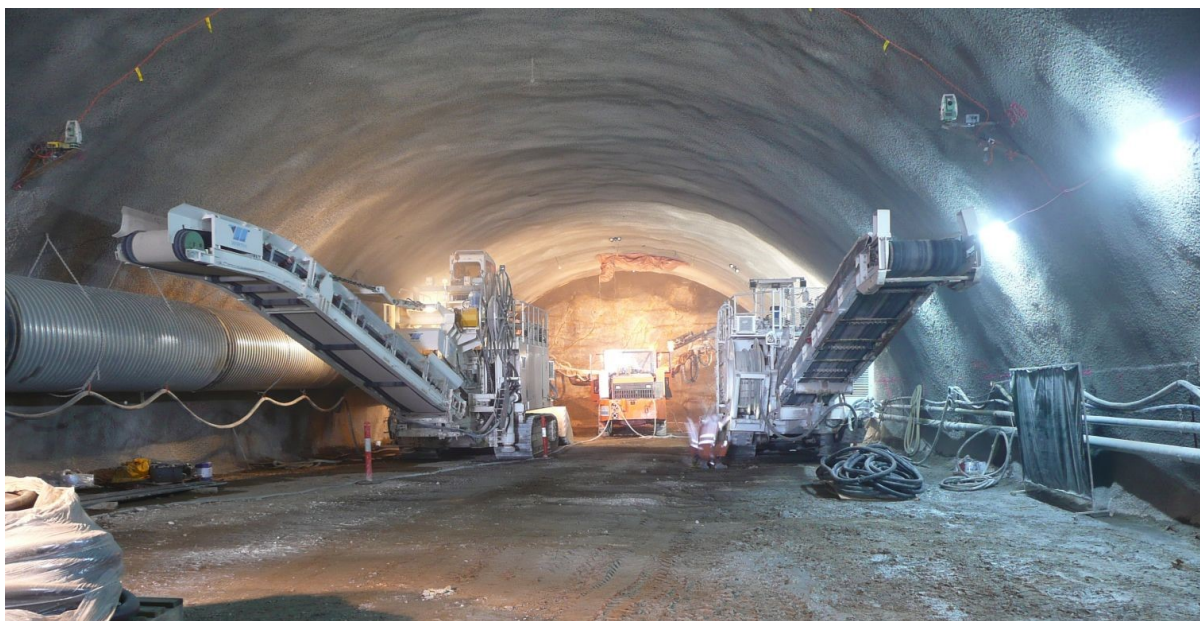
Figur 3.6: Stuff lett tilgjengelig for maskiner. Ventilasjon installerte tett inn til stuff.
