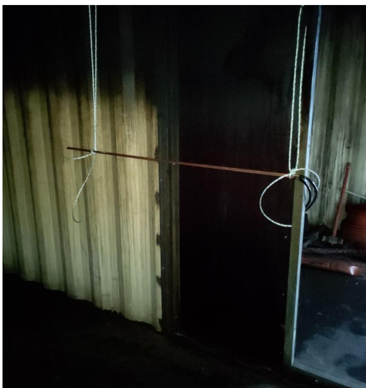
Figur 3.4.1: Ferdig montert målesonde.
