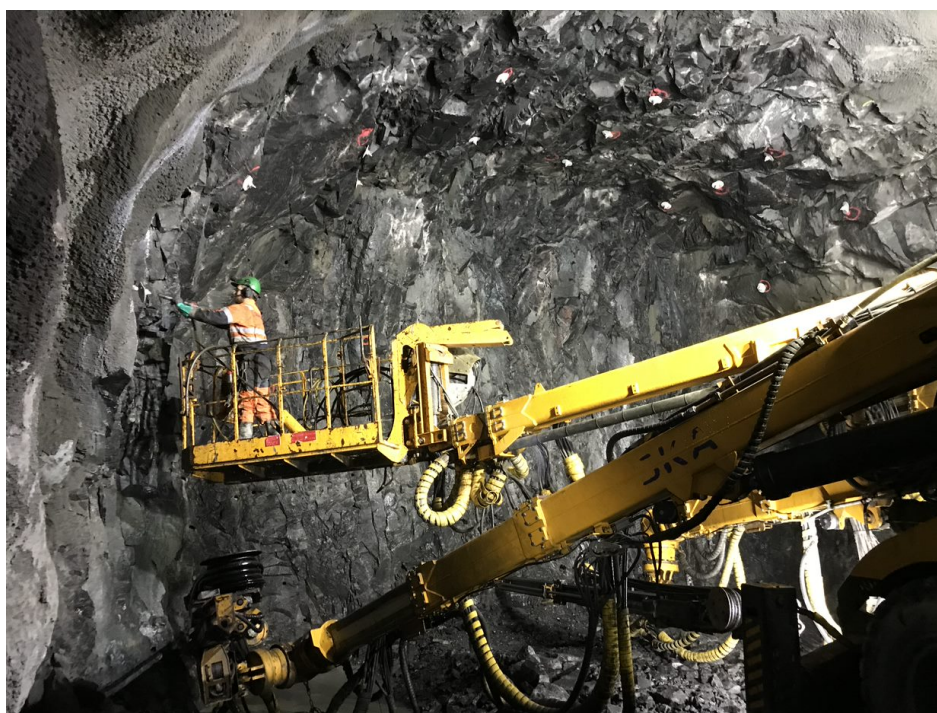
Figur 5.1: Her boltes det under eller i nærheten av faresonen. Borebommen under er stanset. Foto: privat, med tillatelse fra entreprenør
