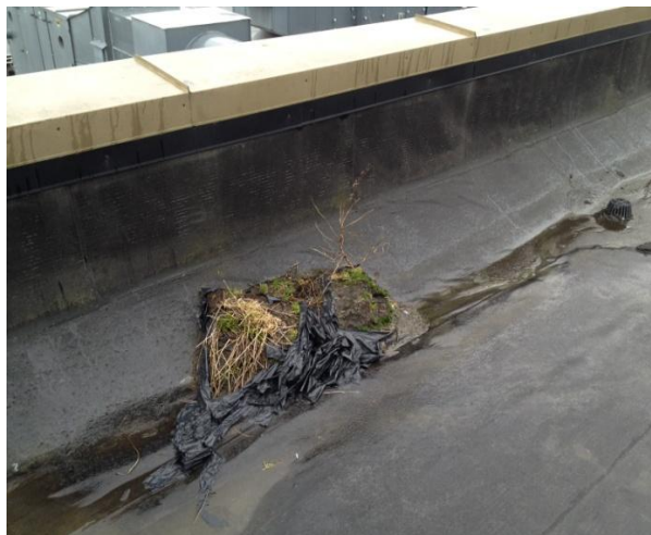
Bilde 2 - Søppel på tak ved tett sluk
