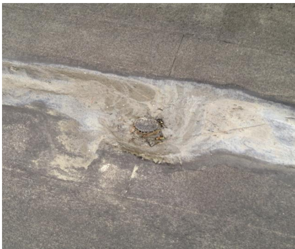
Bilde 3 - Tett sluk på tak
