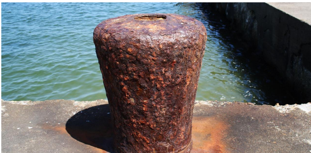
Figur 9. Overflatekorrosjon i marint miljøet [31].
