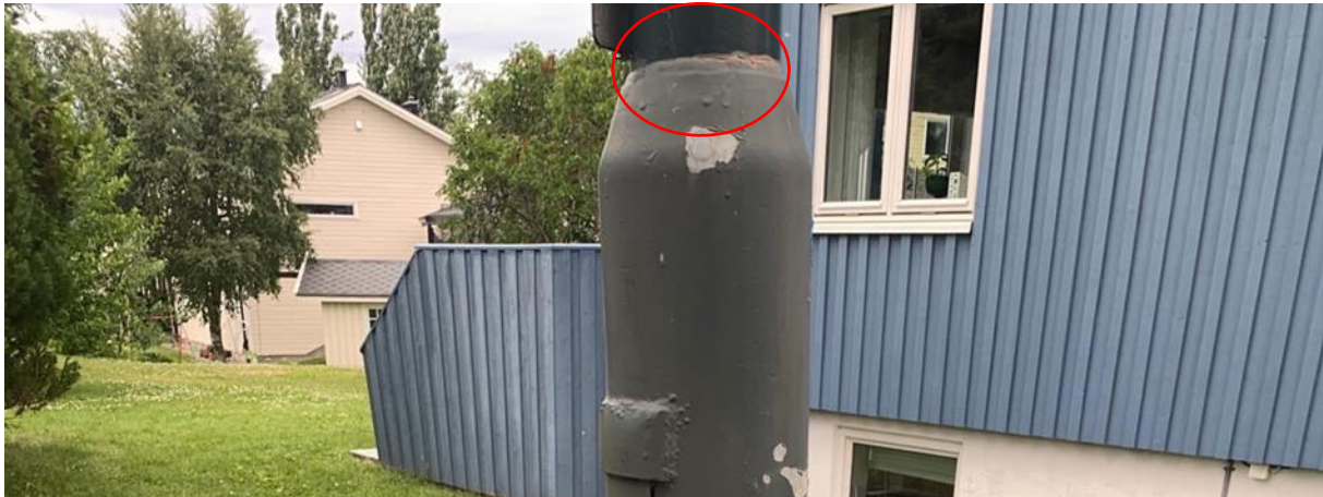
Figur 28. Lyktestolpen #4, Marie Wexelsens gate. Området som er markert med rødt viser hvor oppstår galvanisk korrosjon.
