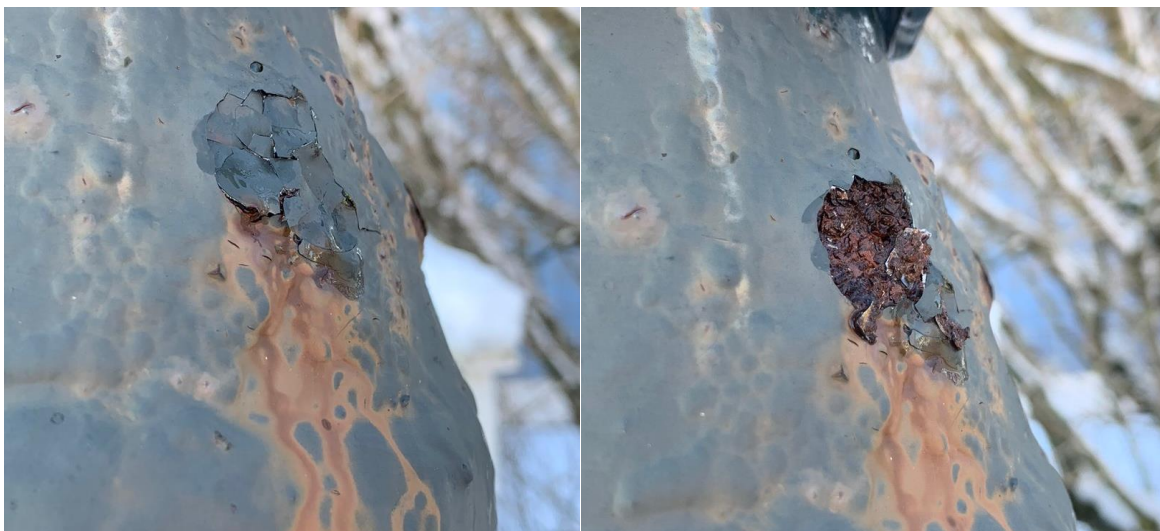
Figur 30. Spaltkorrosjon under maling, masten #1, Marie Wexelsens veg. Til høyren - spaltet ble ødelagt, og man kan se korrosjonsprodukter.
