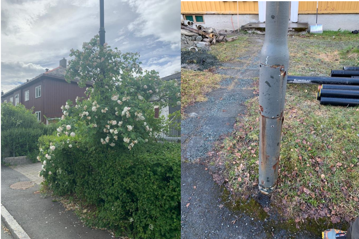
Figur 25. Til venstre - det nyeste bildet av masten #2 (Guttorms gate). Til høyre - liknende masten fra Gattes gaten.
