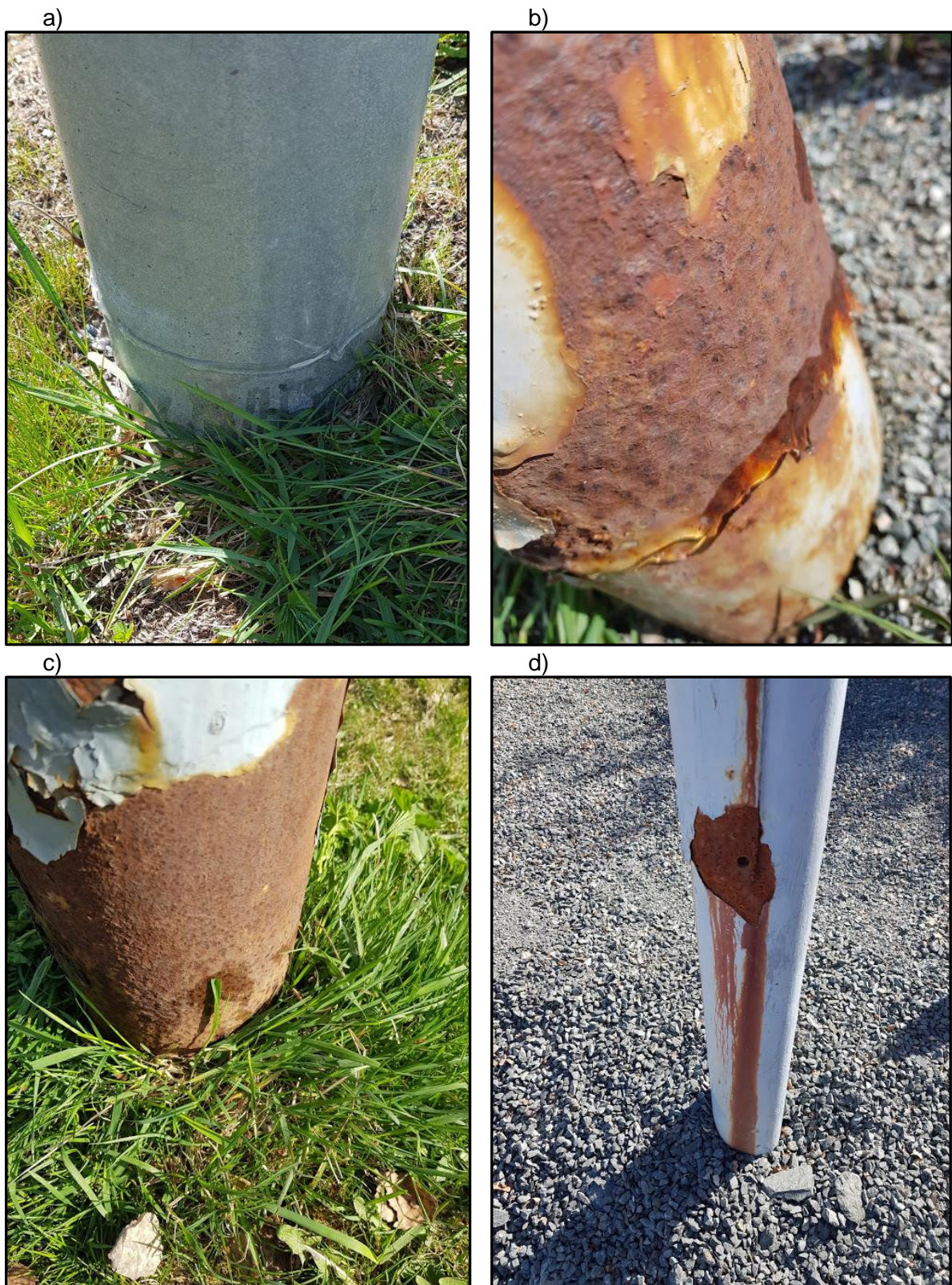
Figur 33 - Bilder av master ved bakkenivå fra Lokasjon A. Bilde a, b, c og d er henholdsvis mast A24, A22, A20, og A19. På bilde a og b er det gel som er påført rundt nedre del av mastene. Bilde c viser en jevn overflatekorrosjon, med forekomst av små groper. Bilde d viser en intakt måling i nedre område av masten, men er ellers påvirket av korrosjon.
