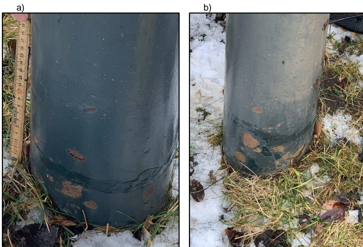
Figur 36 - Bilder av nedre mastseksjon til mast C1. Masten er ikke galvanisert.
