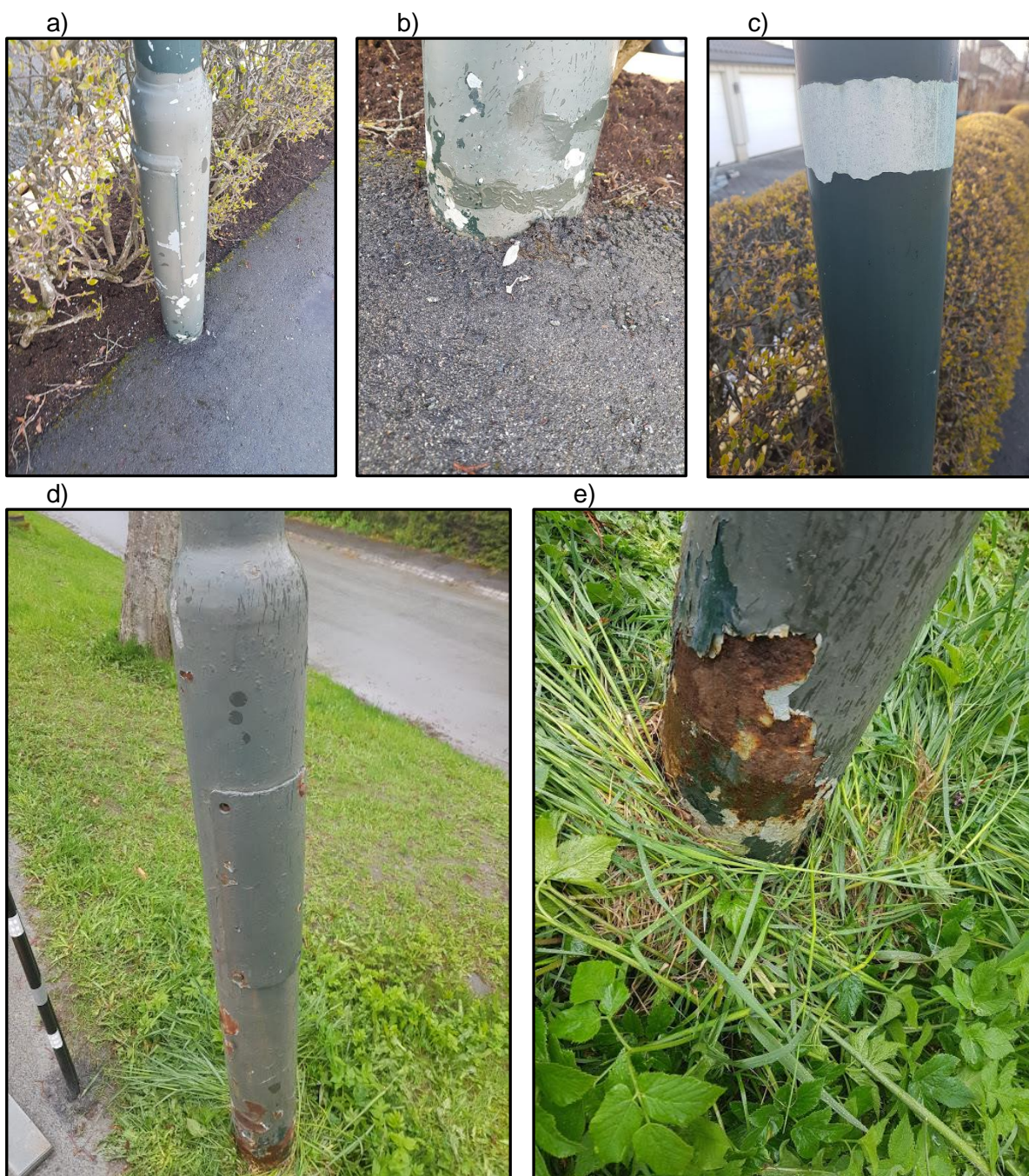
Figur 35 – Bilde a, b og c er av mast B1, og det kan tydes at det er en helgalvanisert mast under malingen, uten tydelige visuelle tegn til korrosjon. Bilde d og e er tatt av mast M3, som viser åpenbare tegn til korrosjon på den nedre del av masten. Det kan også sees i bilde e at det er to lag med maling.
