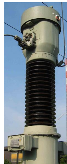
Figur 19: 110kV strømtransformator (Hentet fra Wikipedia, 2021)
