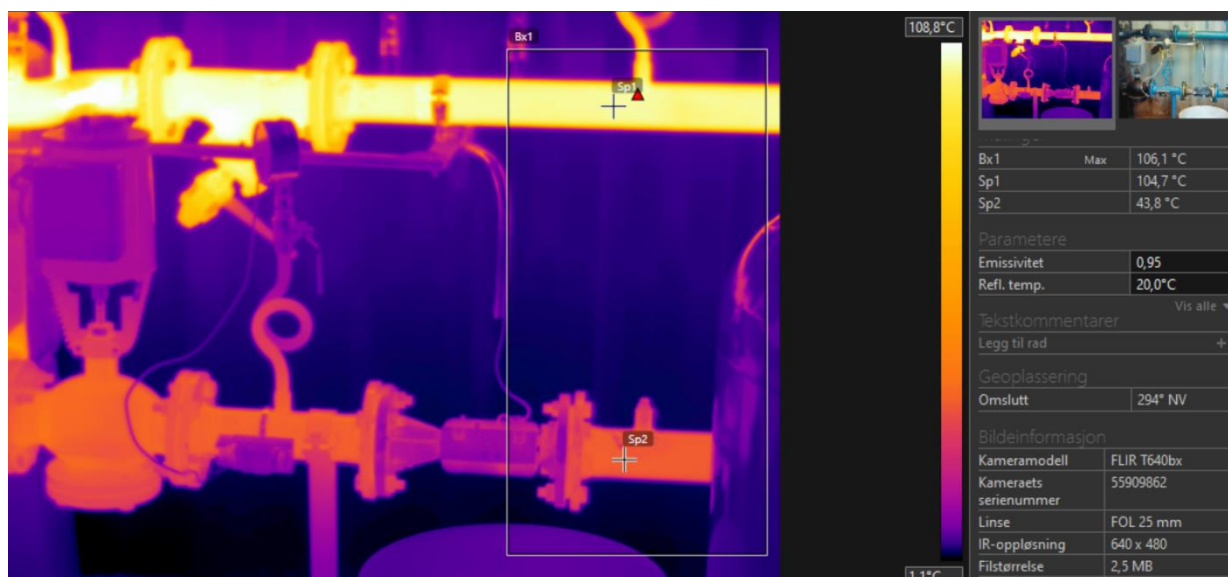
Bilde 13 Varmerør primærside
