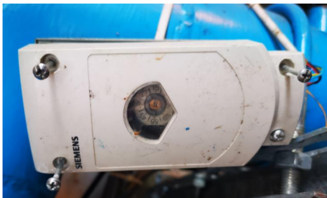
Bilde 10 Høytemperaturvakt på turrør
