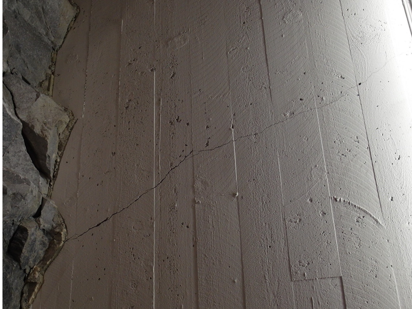
Figur 5.3: Sprekk i betongsøyle i maskinsalen, nr. 4 fra nord i nedstrøms vegg. Foto: Ingrid Gulbrandsen, 13.09.2019.
