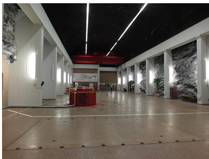
Figur 1.1: Maskinsalen i bildet utgjør øvre halvdel av kraftstasjonshallen til Brattset kraftverk. Kranbanen vises bakerst i bildet og en av gulvlukene fremst i bildet. Foto: Ingrid Gulbrandsen, 13.09.2019.
