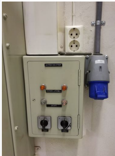
1d - Ventilation fan switch
