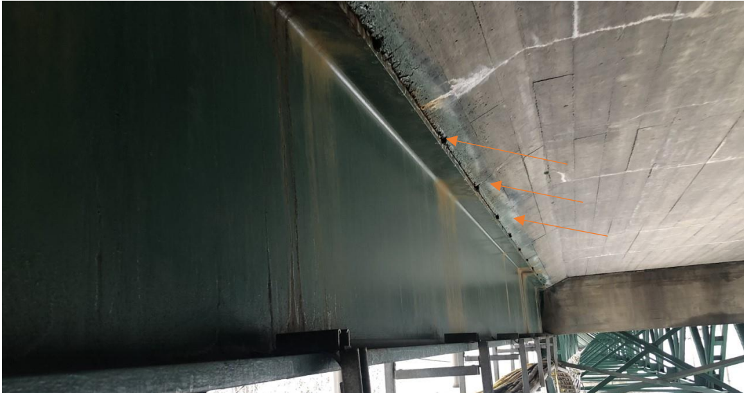
Figur 36: Tre av fastholdelsene mot vipping av toppflens til DIP-90-bjelken i endespennet er vist med oransje piler
