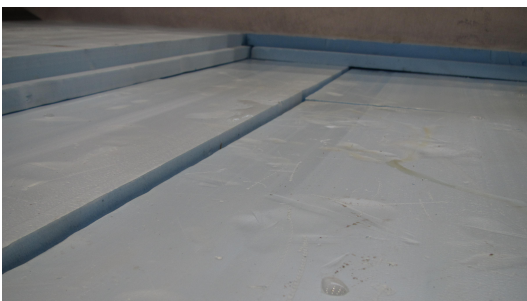
Figur 68: Bildet viser at ujevnheter grunnet småsingel under isolasjonssjiktet, gir større gap noen steder
