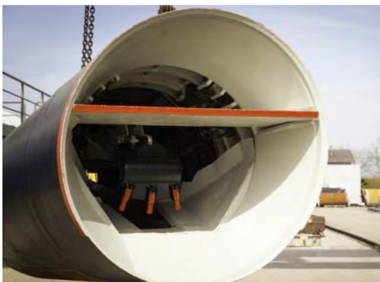
Figur 4 Startrør med åpen rørfront (VT Vortriebstechnik, 2017)
