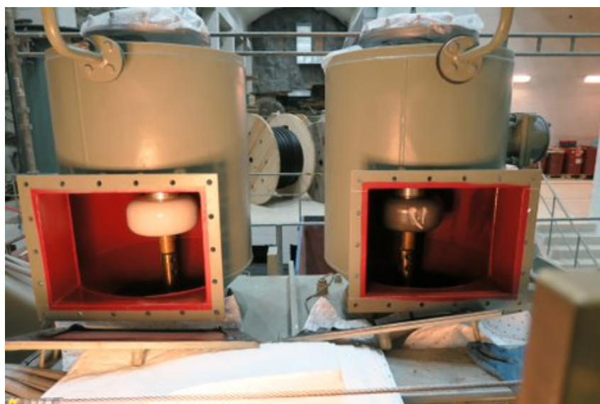
Figur 4.15: Koronaskjold i fase L1 og L2 (Statkraft, 2017d)
