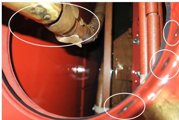
Figur 4.11: Skader på kobberledning og gjennomføring (Statkraft, 2017c)
