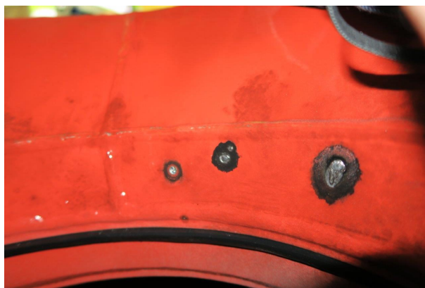
Figur 4.12: Skader på innsiden av gjennomføring (Statkraft, 2017b)
