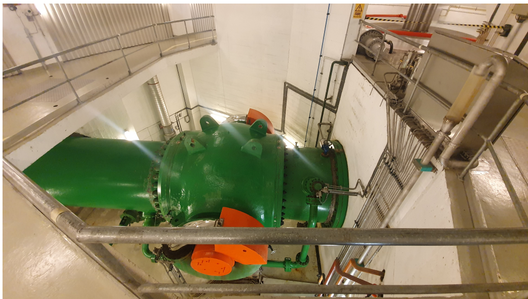
Figur 7.4 – Ventilgrop Sima vannkraftverk [54].
