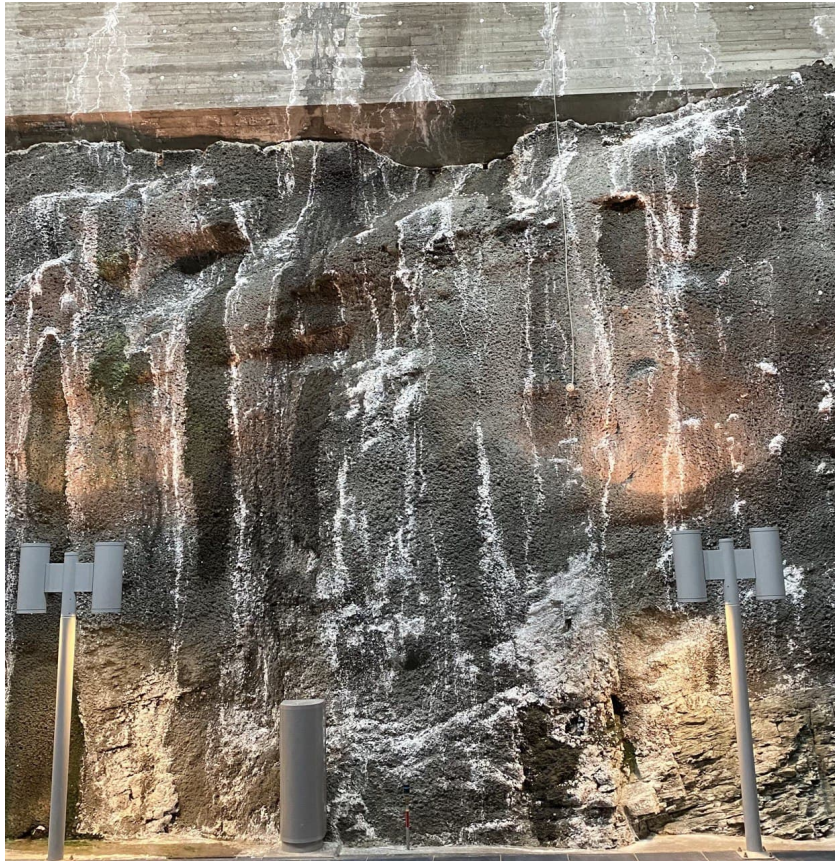
Figur 3.11 – Saltutslag, lekkasje fra fjellet og en diffuser-doner.
