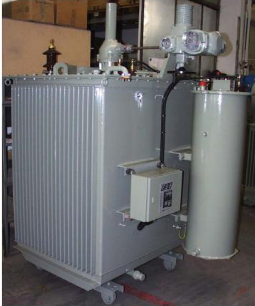
Figur 9: Jordslutningsspole av dykkjern type for 22/rot3 kV, 10-100 A, 2 timers drift og utstyrt med parallellmotstanden er sylindere til høyre for styreskapet vedlegg [1]
