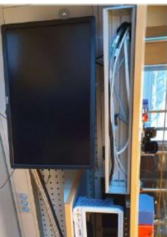
Figur 1: Bilde av kanal på lab plass.
