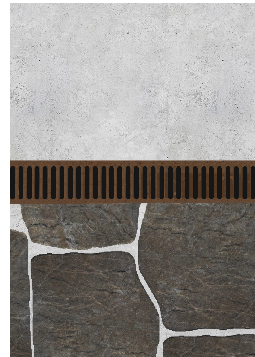
Møte mellom opprinnelig skifer, ny betong og renne
