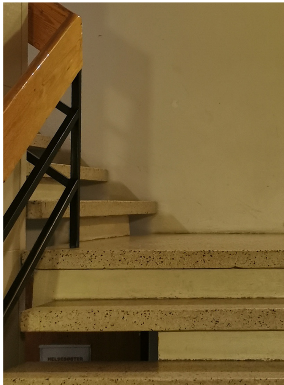
Innvendige trapper er i terazzo, med rekkverk i støpejern med bred trehåndlist.
