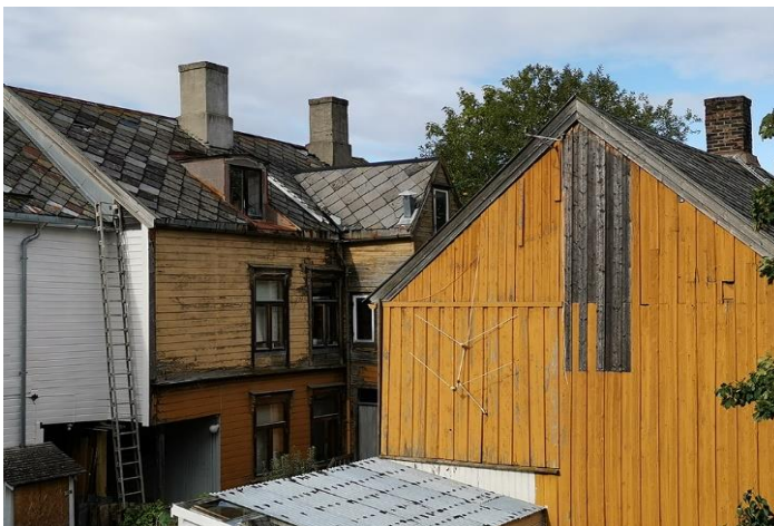
Figur 7 Bilde viser tilstanden på baksiden av Gensen 9A/B Foto: Arunas Palionis 03.09.19
