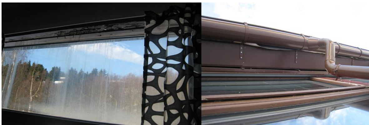
Bilde 4 - Fuktskade Skole 3
