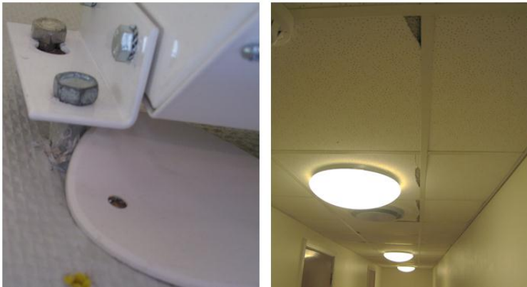
Bilde 3 - Skader Skole 2
