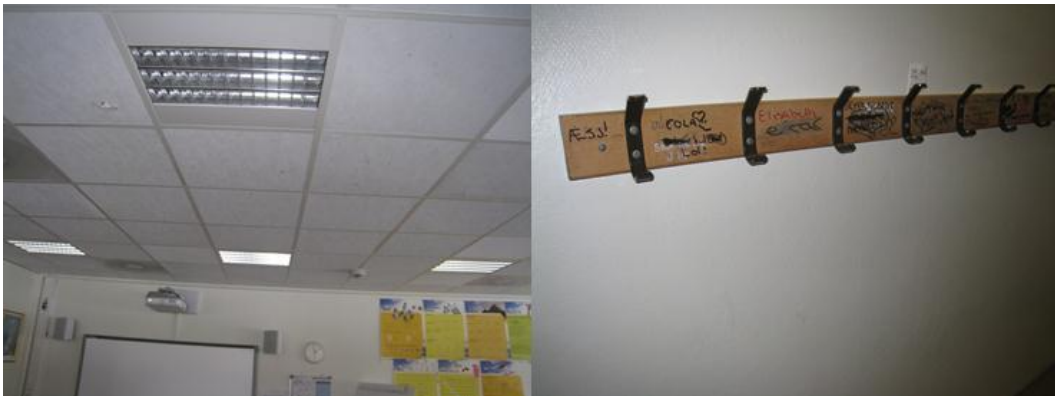
Bilde 2 – Skade tak og knaggrekke
