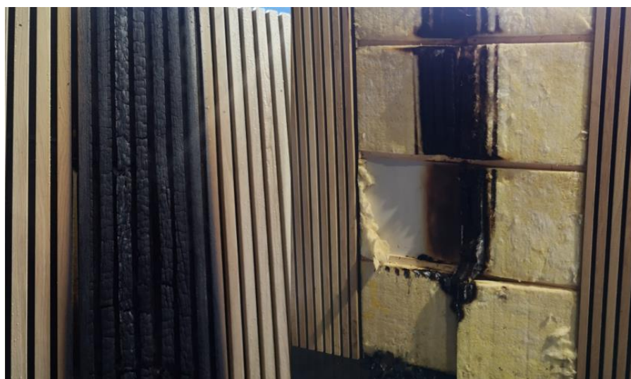
Figur 5.12: Skadet areal etter test 2
