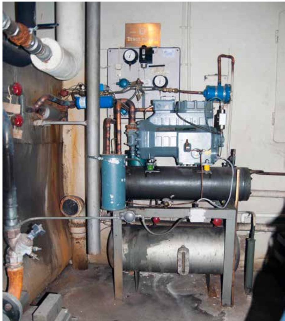
Maskineri, en del av kjøleanlegget til ventilasjonen i maskinrommet i kjelleren.
