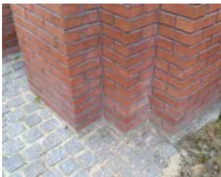
Venstre: Museet: induer og ytterhjørnets møte med bakken. Høyre: Politihuset: vinduer, fasade og ytterhjørnets møte med bakken.
