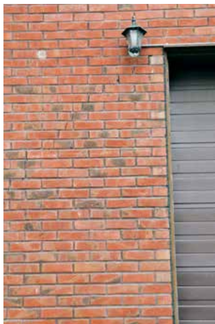
Vesntre: Saltutslag ved søndre takrenne på østfasaden. Høyre: Sprekk på østfasaden fra øverst ved vareporten og ned mot venstre.
