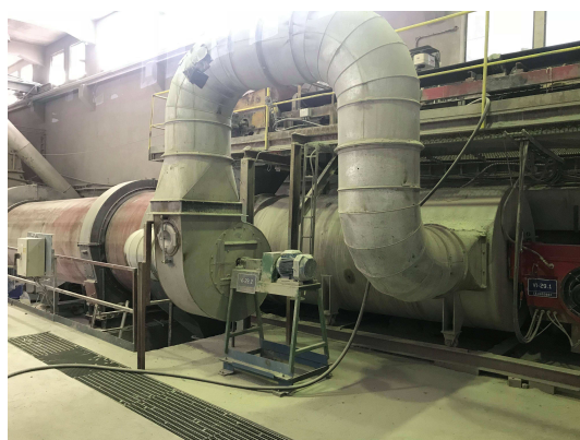
(a) Sirkulering av luft i tørka
