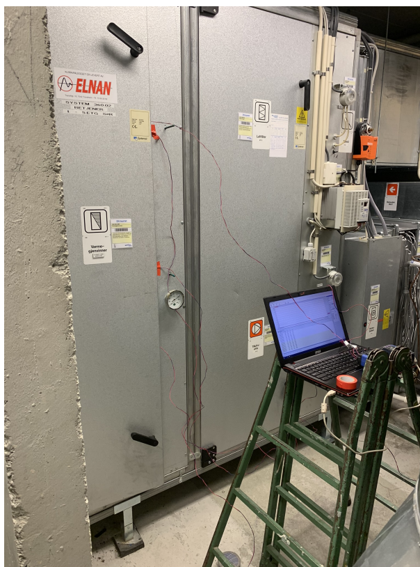
Figur 4.16: Måling varmegjenvinningsgrad aggregat 360.02
