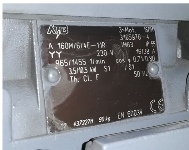
Figur A5.2: Merkeskilt viftemotor avtrekkvifte 360.01
