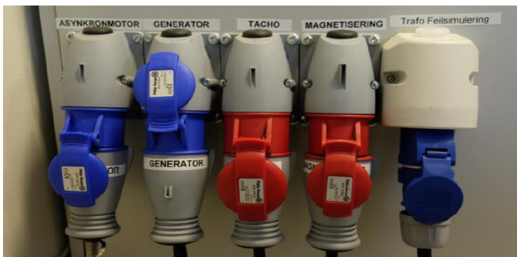
Figur 14 Rundstifkontakter venstre side av kontrollskap
