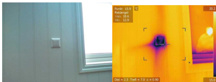
Figur 30: Bildet viser en luftlekkasje ved lysbryter (42). Det er ikke brukt påfôret lag på innsiden av dampsperran.
