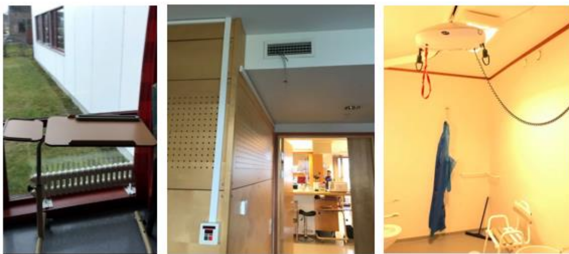
FIGUR 8: VINDU MED RADIATOR, VEGGMONTERT TILLUFTSVENTIL OG AVTREKK PÅ BAD.
