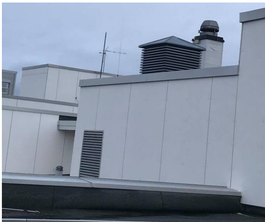
FIGUR 7: LUFTINNTAK OG AVKAST TIL VENTILASJONSAGGREGAT 36.02, VESTVENDT OVER FLØY D.
