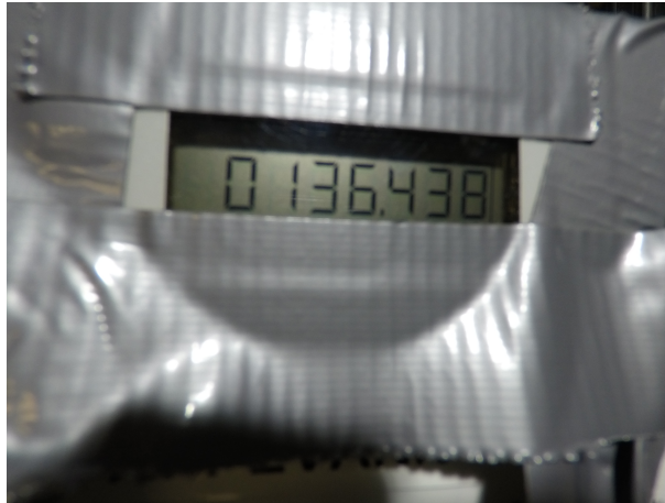
Figur 3.5: Bilde av energimåler ved Åsveihallen. Enheten til måleren er MWh.
