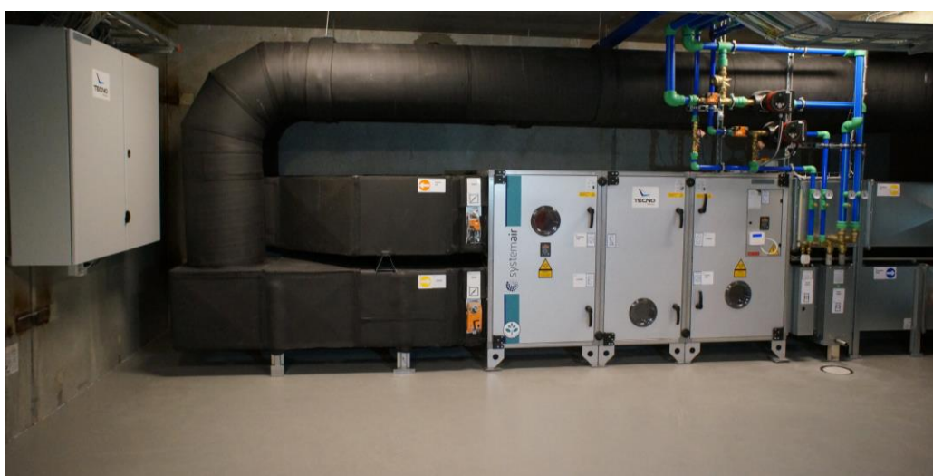
Figur 11: ventilasjonsaggregat ved Lundhaugen omsorgsenter med varme- og kjølebatteri.
