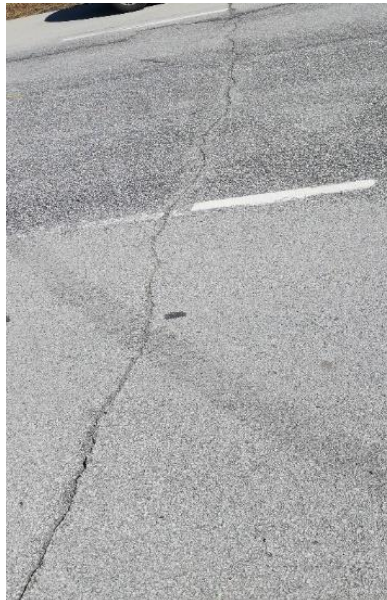
Figur 8: Bilde fra befaringsviser store sprekker i asfalten (Bilde er tatt av Christine Granum Nygård 20.4.2020)
