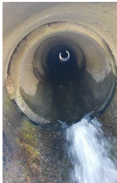
Figur 10: Bilde fra befarings viser rørelement som har glidd ut av posisjon (Bilde er tatt av Christine Granum Nygård 20.4.2020)
