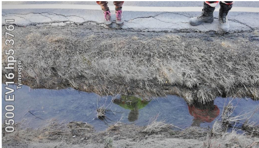
Figur 2: Bildet fra befaringen viser hvordan dårlig kapasitet på sidegrøfter kan føre til overvann som fører til oversvømmelser (Bilde er tatt av Christine Granum Nygård 20.4.2020)
