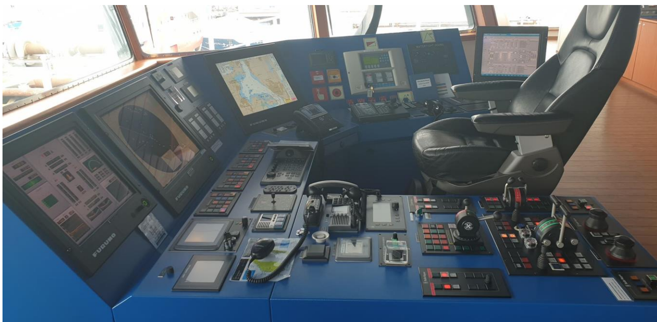
Figur 2-24 Plassering av utstyr på skipsbro foto: Ruben Haugen
