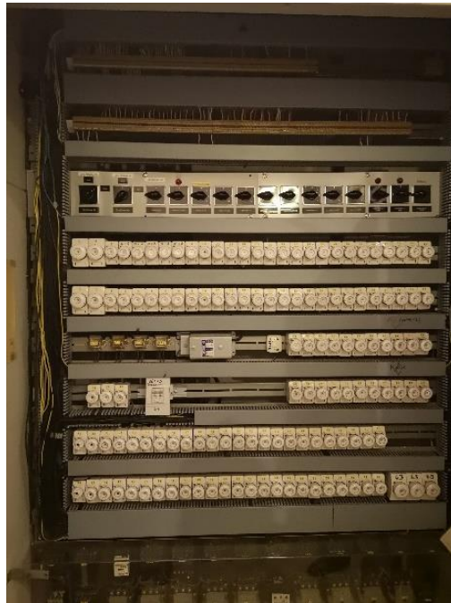
Figur 31: EL-skap med skrusikringer. Utdatert. Bilde fra befaring NKIM 31.01.2020
