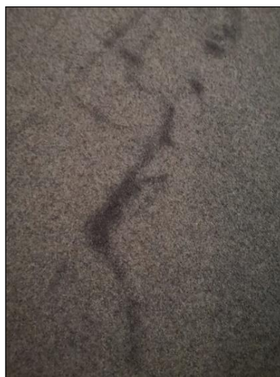
Figur 19: Konstant vanntrykk mot fundament. Synlig i teppeflis i kjeller. Befaring NKIM 31.01.2020
