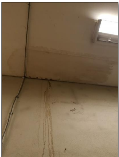
Figur 18: Synlige fuktskader i kjellervegg. Befaring NKIM 31.01.2020
