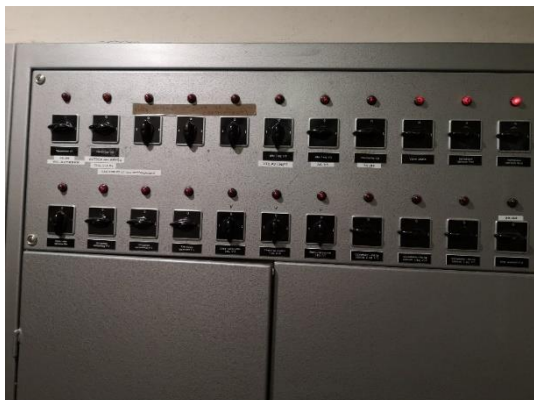
Figur 30: Manuell styring av ventilasjonsanlegget. Fløre brytere er ute av drift. Befaring NKIM 31.01.2020
