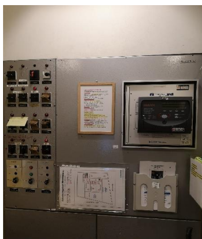
Figur 32: Styringspanlet bak respesjonen. Utdatert. Bilde fra befaring NKIM 31.01.2020
