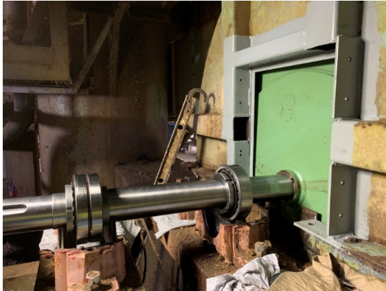
Figur 27: Serviceluke på vifte 4 oppfanger 3
