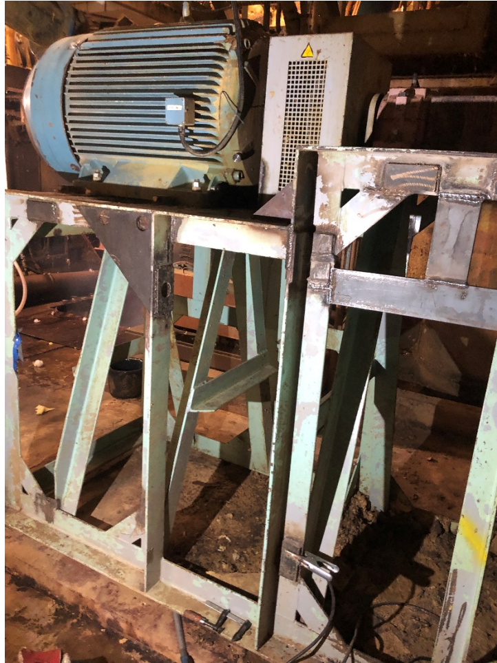
Figure 31: Vifte 4 med utførte reparasjoner og forsterkninger
