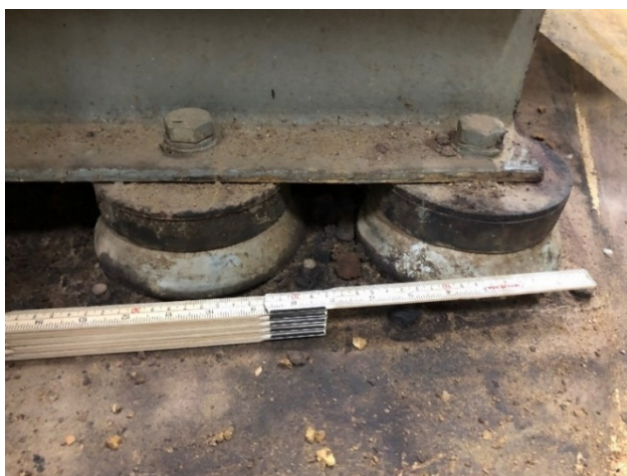
Figur 34: Maskinføtter på vifte 5, oppfanger 2
