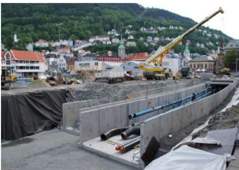
FIGUR 30: VANN OG AVLØPS KABLER GÅR I EN KULVERT TUNNEL UNDER BAKKEN I BERGEN (VANYTT, 2015)
