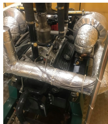
Bilde 2: CHP generator
